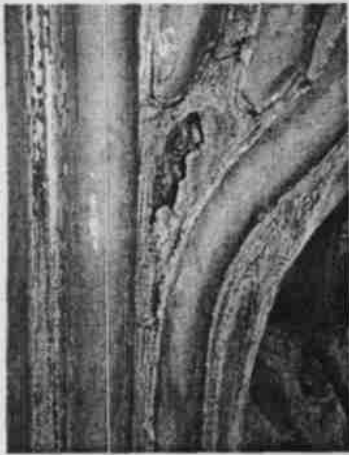
图 2 喷嘴附近膜式水冷壁的腐蚀情况
