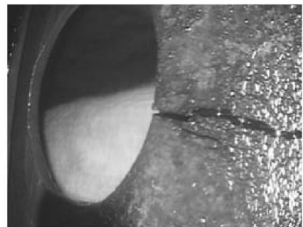
图 1 主燃孔裂纹放大图
