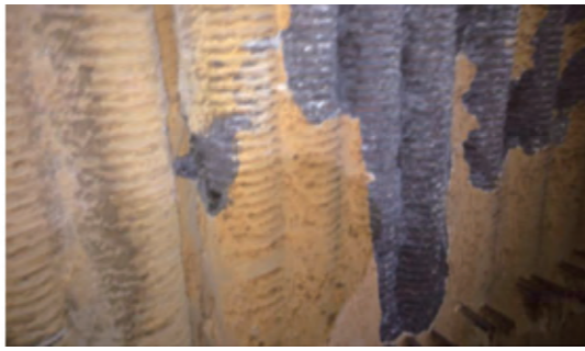
图 2 130 t/h 锅炉新增低温受热面触碰后积灰脱落
