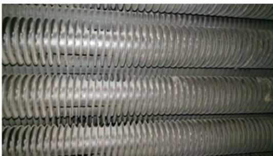
图 4 75 t/h 锅炉新增低温受热面情况
