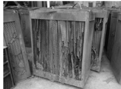
图 7 空预器腐蚀现场图片
