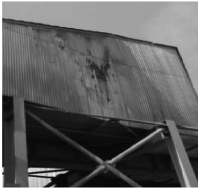
图 6 尾部受热面腐蚀现场图片
