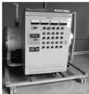
图 3 柴油机模拟负载 - 电热水锅炉
