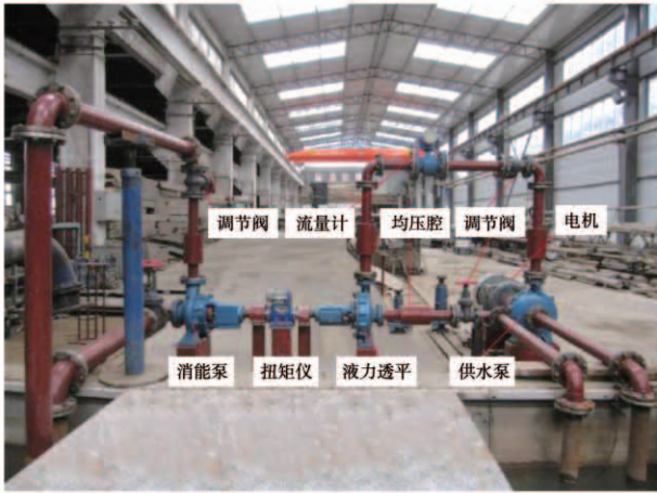
图 2 液力透平试验台
