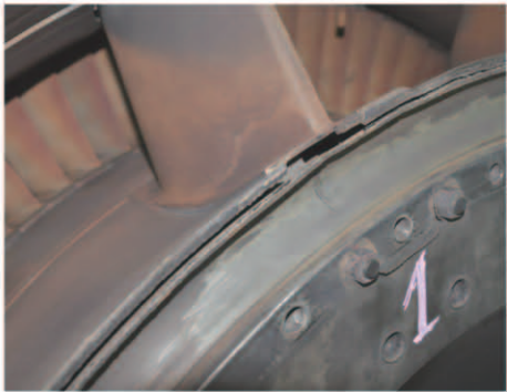
图 2 内罩壳与月牙板间焊缝开裂
