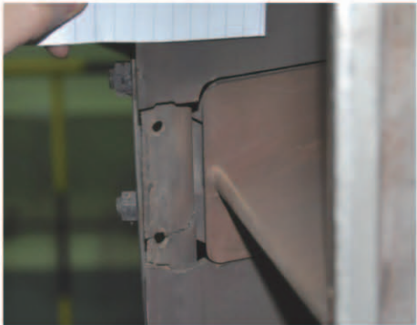
图 3 内罩壳撕裂掉块
