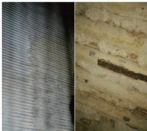
(a) 腐蚀区域
